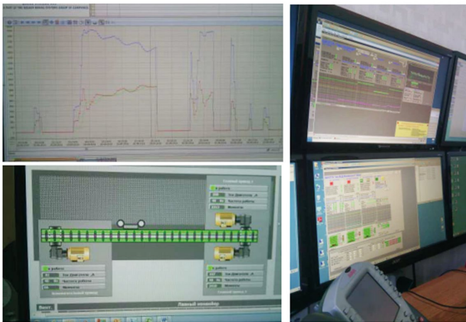
Rys. 10. Widok przykładowego centrum dyspozytorskiego z wizualizacją pracy silników [Źródło: opracowanie własne]
